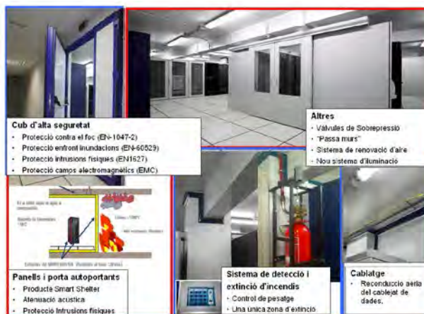
Figura 22. La Sala de Màquines d'alta seguretat
